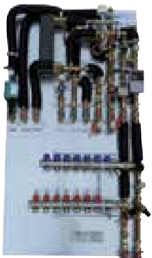
Wohnungsstation für WW mit Zirkulation, Fußbodenheizung mit Einspritzschaltung & Temperaturregelung über GLT (2 Motorventile), Fußbodenkühlung über GLT (2 Motorventile) in Aufputzausführung
