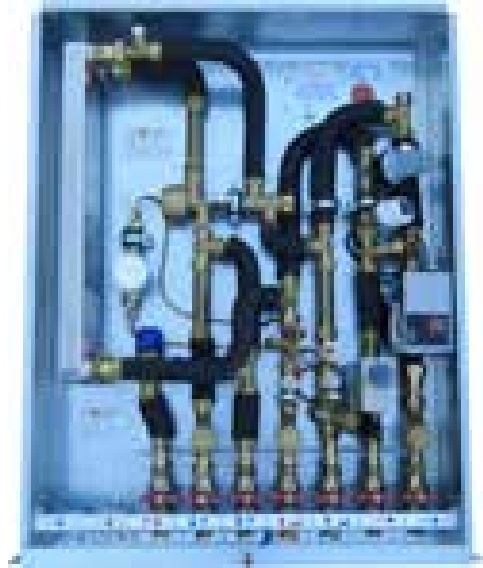
mit Spülmöglichkeit im primär VL + RL mit 3x Schmutzfilter T-Version mit Brauchwassermischer 35-70°C mit WP-Tauscher lang + Festwertregelung im Wasserdichten UP-Einbaukasten 810x610x150mm samt Ablaufrohr
